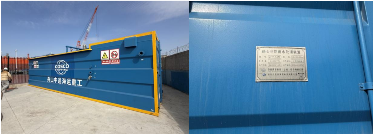
图 8.1-3 码头初期雨水收集处理装置
