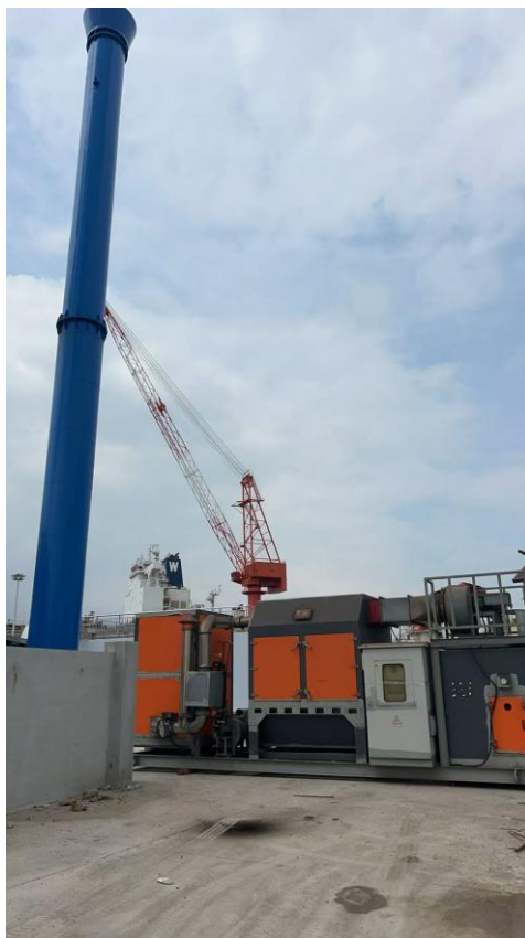
图 9.1-5 集中脱附再生中心
