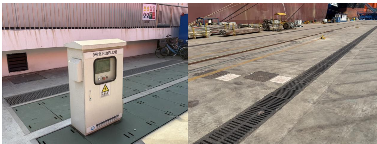
图 8.1-2 码头面集污池和集水沟
