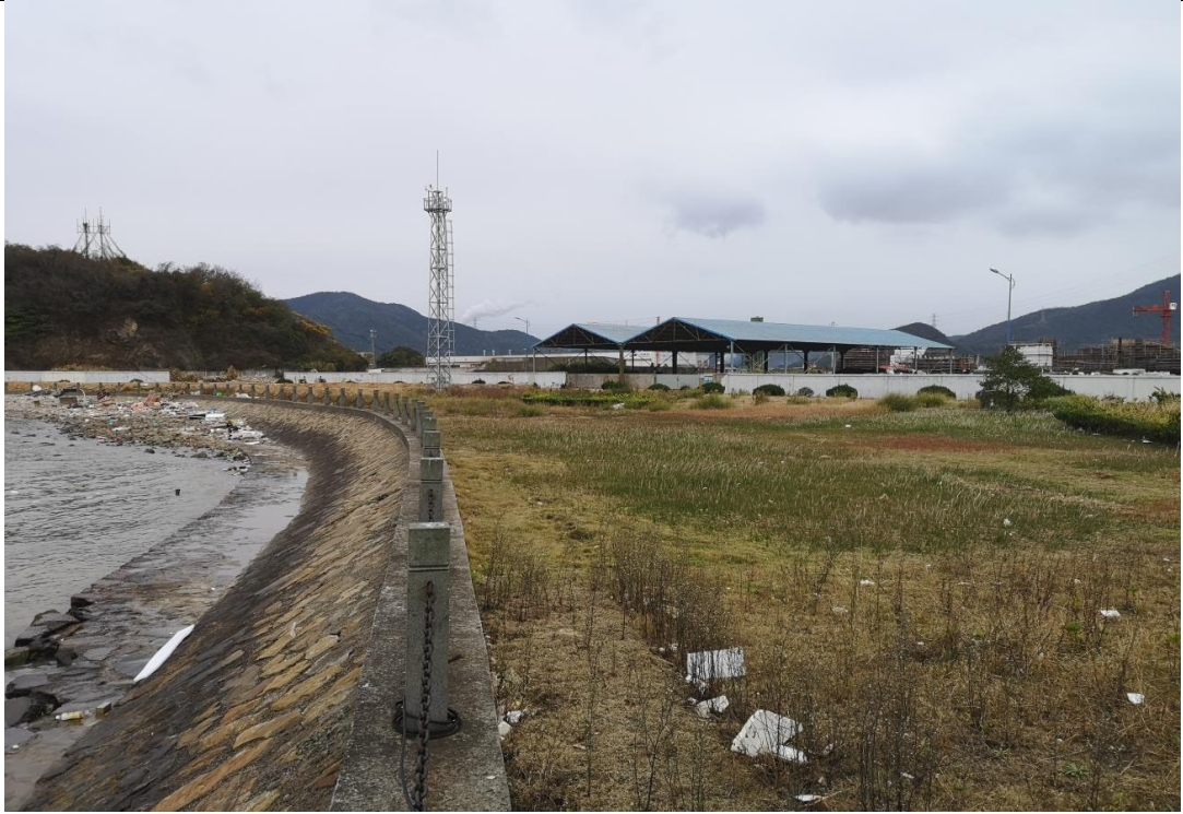
图 3-3 永亨外海塘堤顶路面现状
