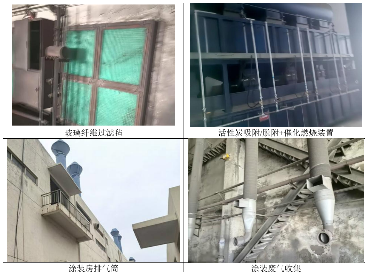
图 3.1-8 涂装房废气治理现状图
