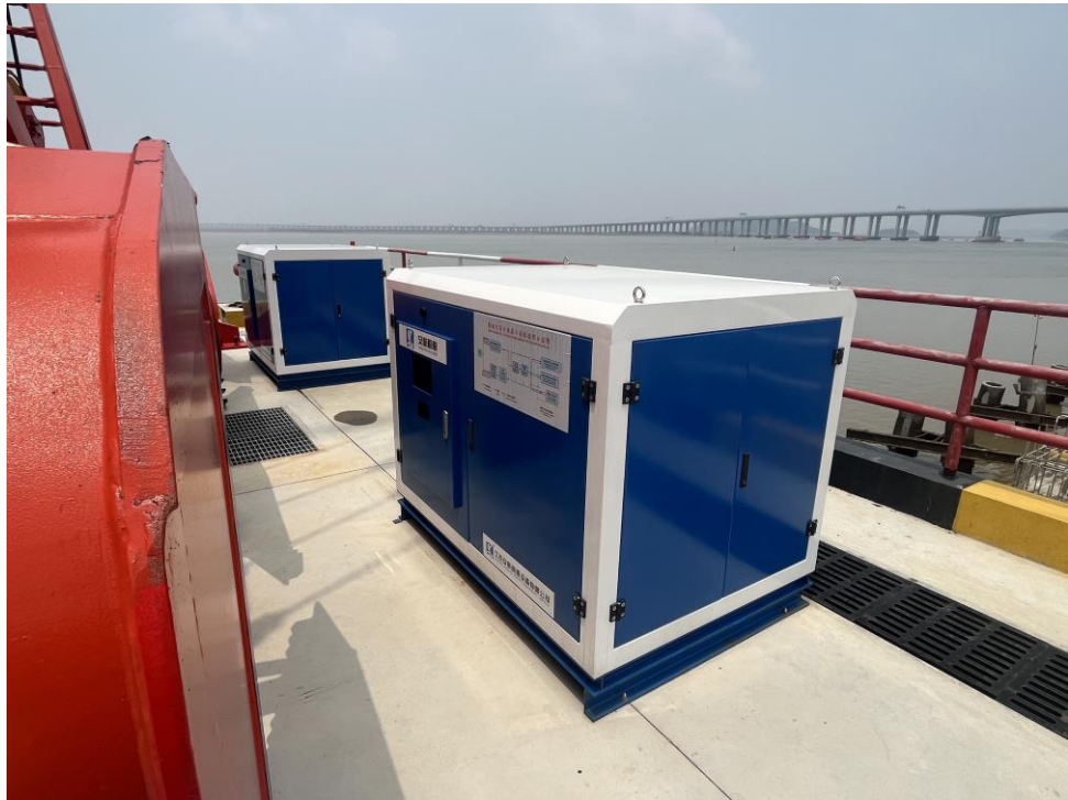
图7-9 码头污水接收设施
