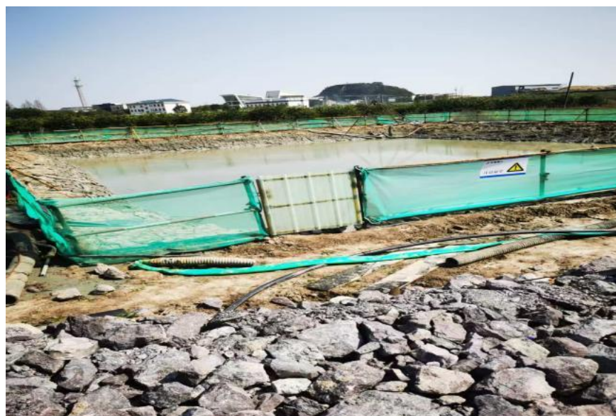
图7-4 施工场地沉淀池
