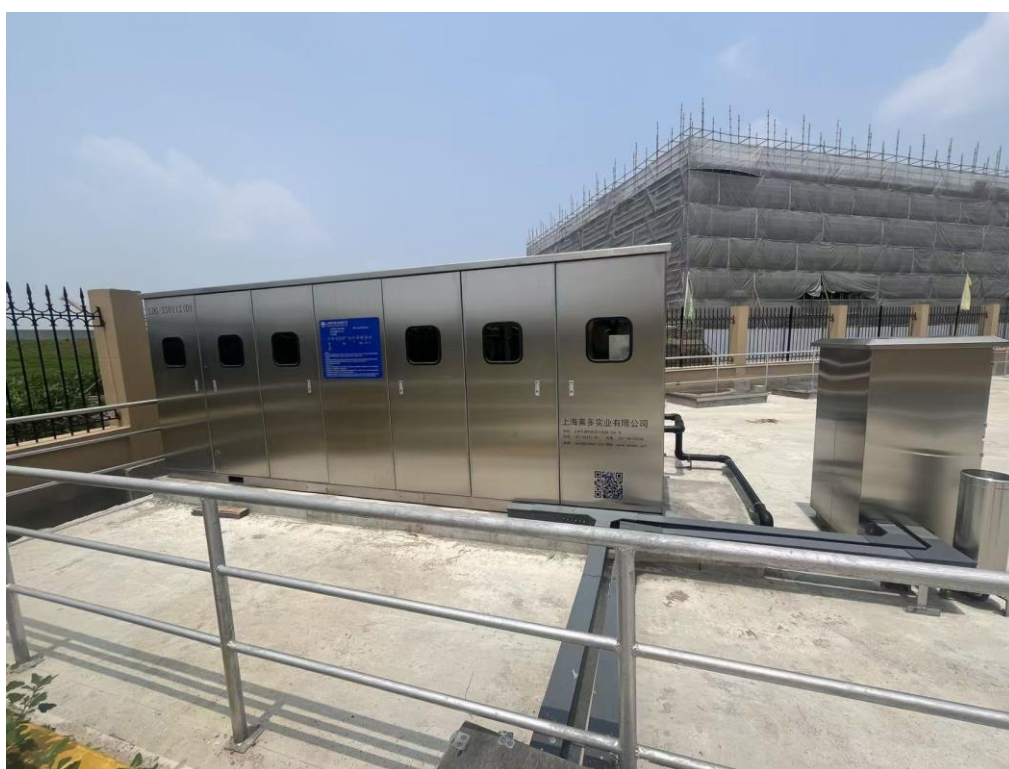
图7-12 初期雨水处理设施
