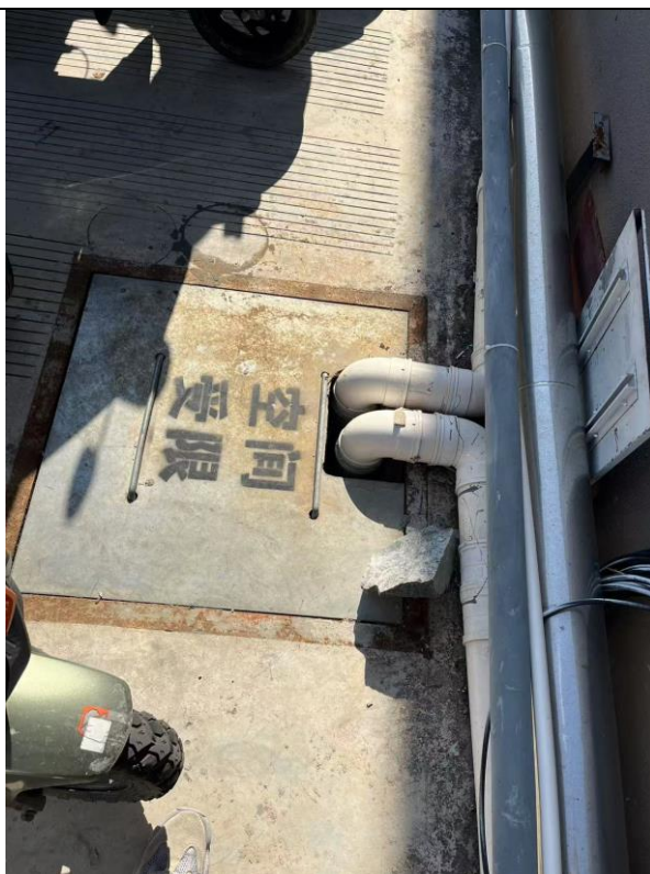
图7-4 码头平台候船楼化粪池
